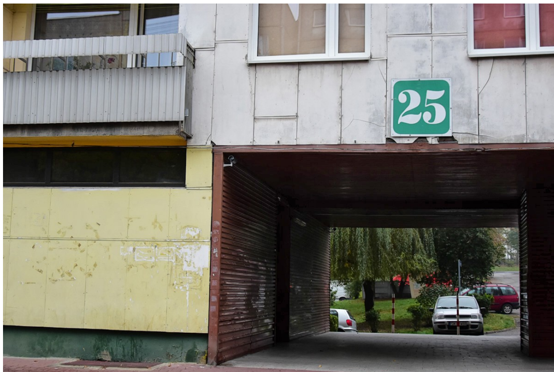
Fot.15. Widok budynku od strony południowej. Prz tabliczce z numerem znajdują się szczeliny, które należy zabezpieczyć (aut. Szymon Wójcik)
