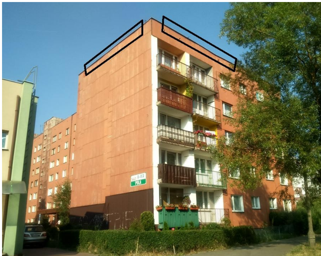
Fot.1. Widok budynku od strony pd-zach. Prostokątami oznaczono wyraźne ciągi szwelin (aut. Szymon Wójcik)
